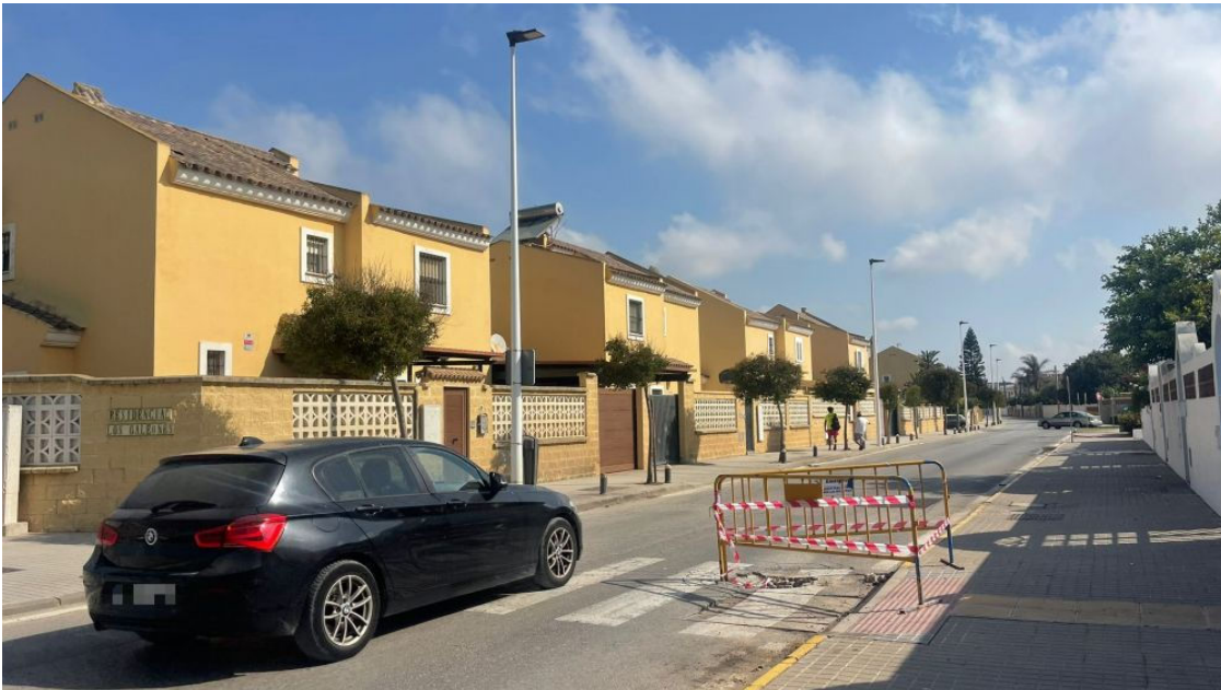
Localizado un nuevo socavón en Rinconcillo que interrumpe el tráfico en la calle Cabo Salines
